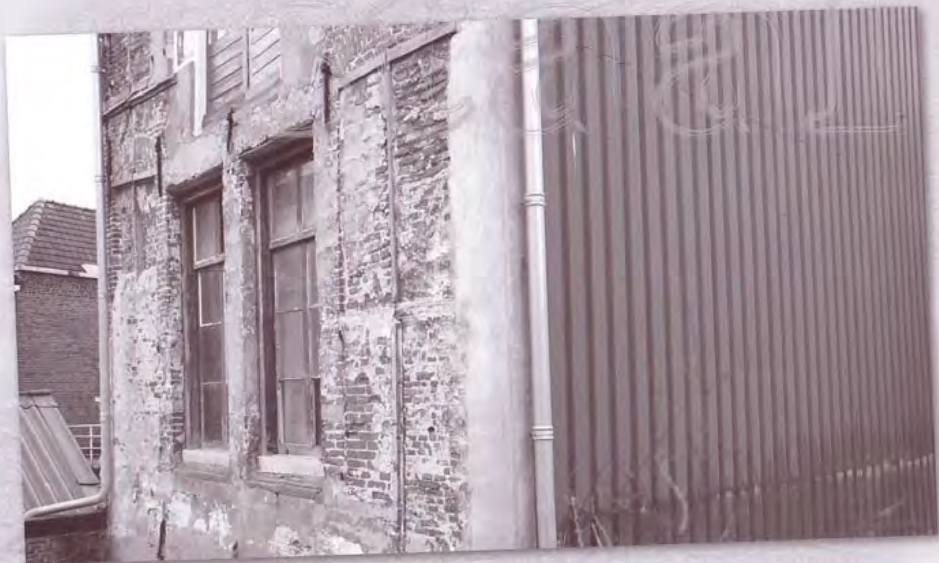
De Noordgevel werd in 1981 gedeeltelijk gesloopt en vervangen door een stalen wand. Het contrast met de 500 jaar oude achtergevel is groot. (Foto Hupkes)
